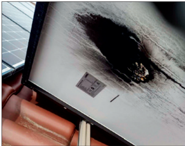
Efekt uszkodzenia instalacji PV
