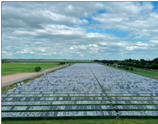
Instalacja zniszczona przez gradobicie
